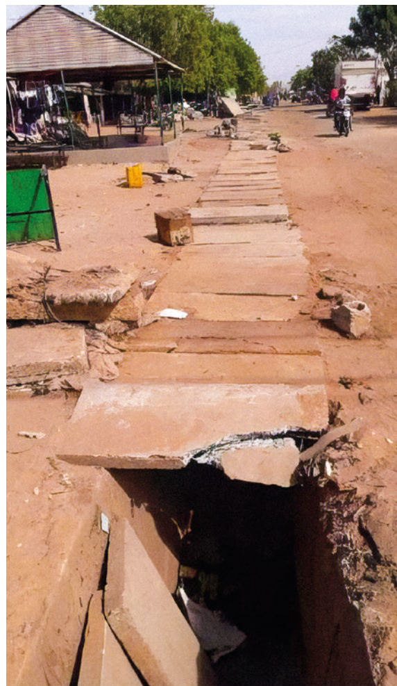
Figure 2 : Canal eau pluvial au marché central de Kafrine
